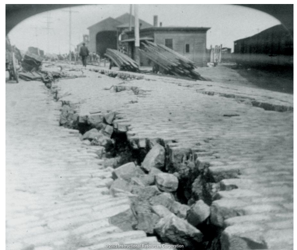
El terremoto de California en 1906 provocó muchos daños. Destruyó esta calle de la ciudad.
